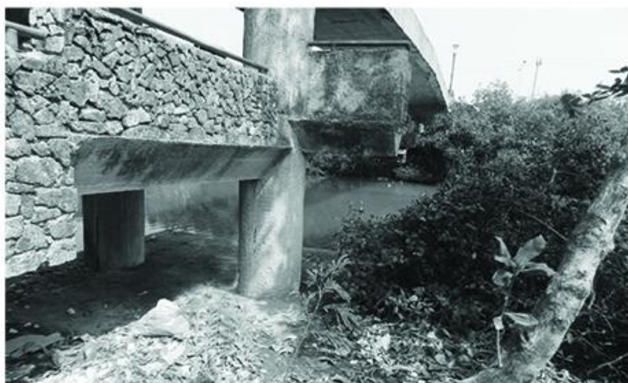
Puente Benjamín Herrera, que comunica a Marbella con Torices, es un tramo donde el Caño, muestra casi la unión de las dos orillas a causa de los desechos contaminantes, que ponen en peligro las vidas de los niños que allí conviven.
